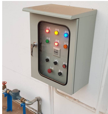
ภาพแสดงตู้ควบคุมเครื่องสูบน้ำเสี้ยน
