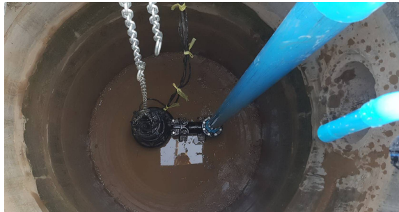
ภาพแสดงบ่อรวมน้ำเสีย
